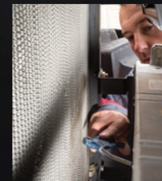
Tantissimo spazio per accedere ai radiatori per gli interventi di pulizia.
